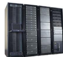
Figure 20: Baie de serveurs
