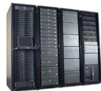
Figure 7: Baie de serveurs
